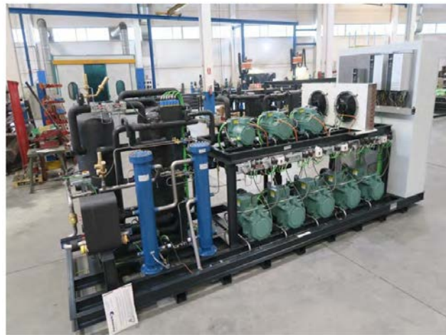
Central Frigorífica sistema CO 2 Transcrítico
