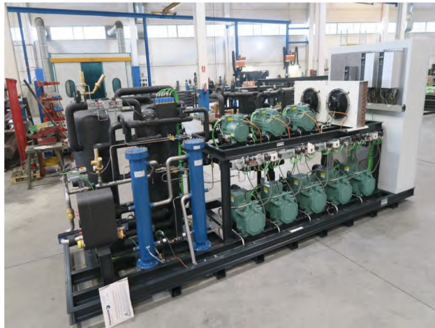
Central Frigorífica sistema CO2 Transcrítico
